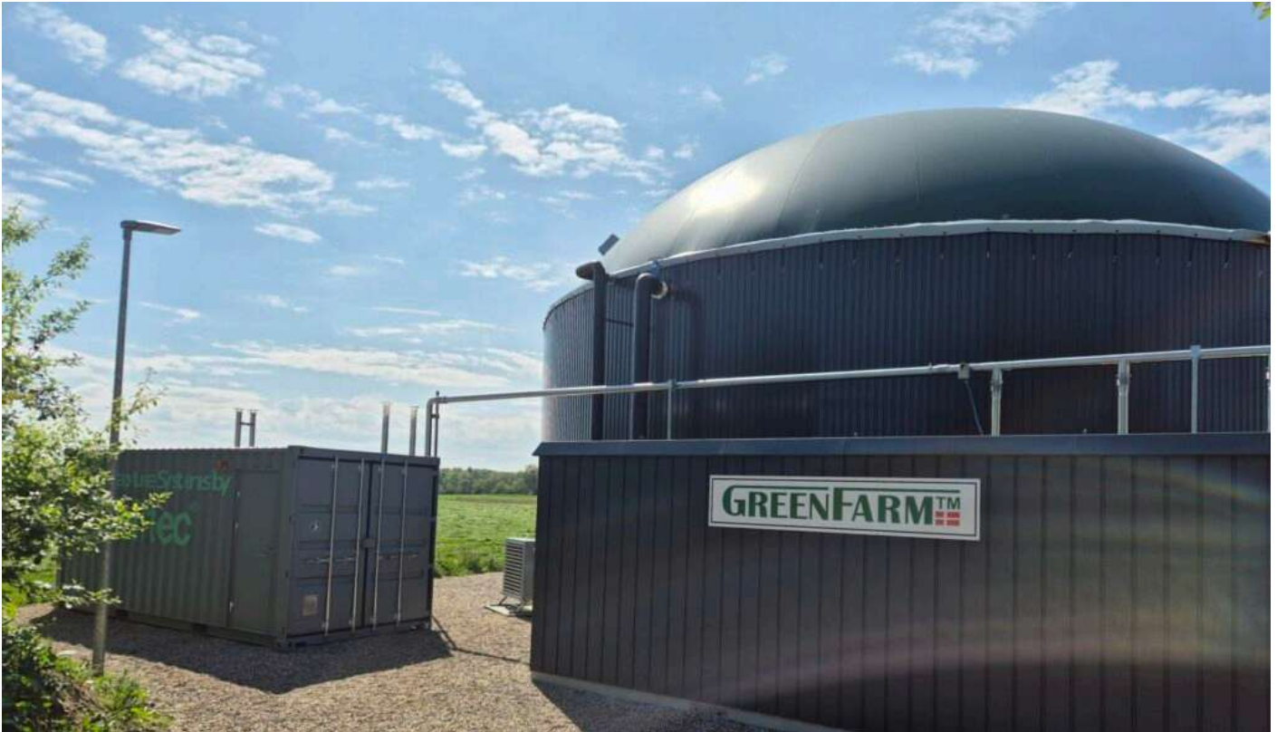
Et biogassanlegg fra GreenFarm.
