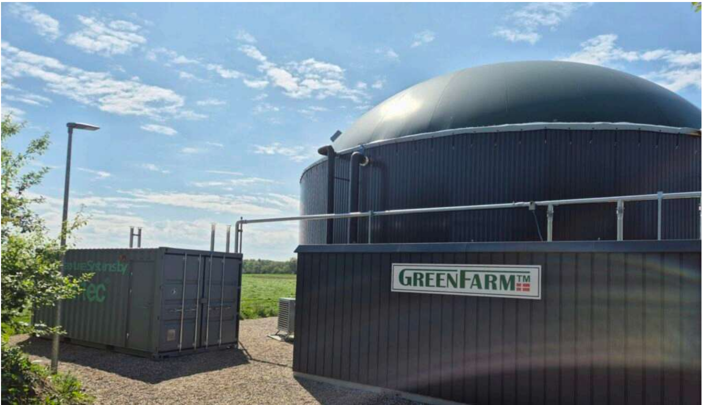
Et biogassanlegg fra GreenFarm.
